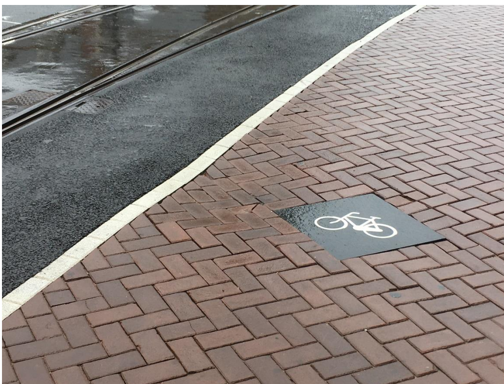
Oneven zijde Vijzelstraat tussen Reguliersdwarsstraat en Muntplein. Deze bestrating ligt hier slechts enkel maanden en in deze korte tijd is er al een kuil ontstaan, ligt de tegel met het fietssymbool scheef in de bestrating en zijn meerdere klinkers gebroken. De geasfalteerde rijbaan is wel vlak.
